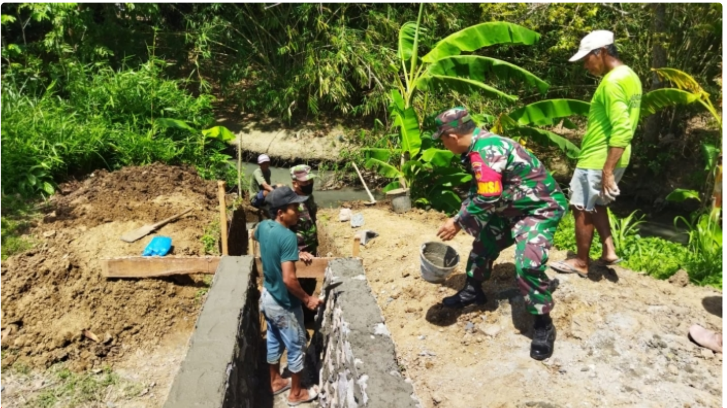
Babinsa Koramil 15/Klirong Bantu Warga Dalam Perbaikan Drainase Dan Gorong-Gorong Parit Jalan
