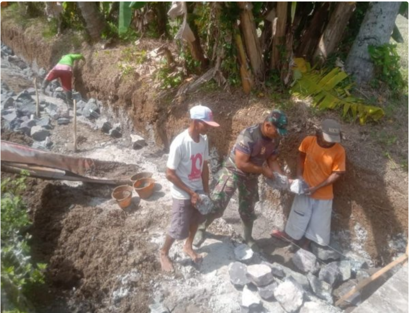
Babinsa Koramil 19/Kuwarasan Sertu Suratno Melaksanakan Giat Karya Bhakti Pembangunan Talud Irigasi Sepanjang 100 Meter.
