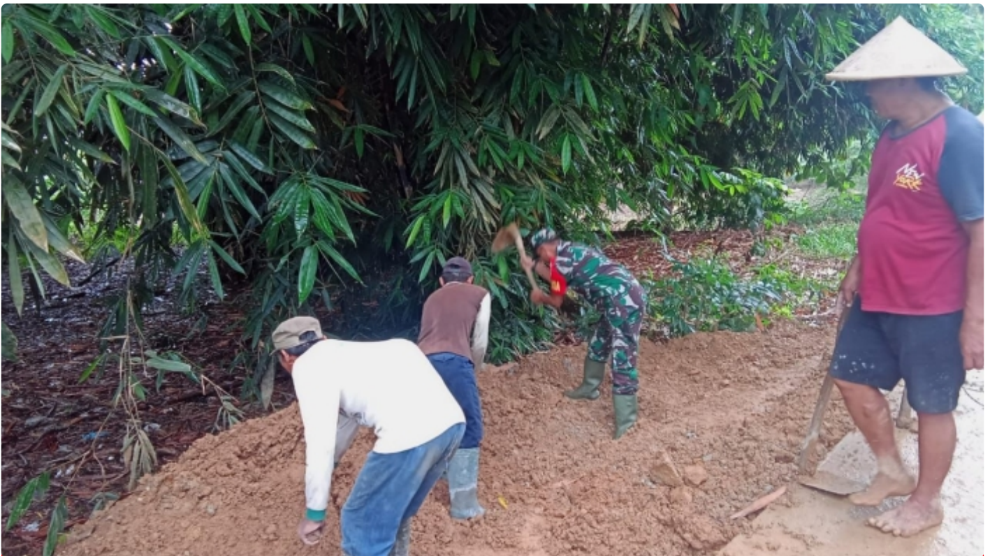
Serda Badri bersama warga masyarakat dan Pemerintah desa Wonoyoso melaksanakan pengurukan bahu jalan desa di Dusun Kedungpandan Desa Wonoyoso
