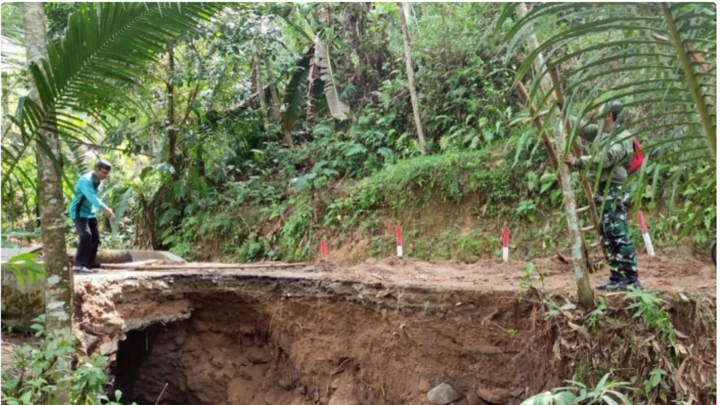
Danramil 22/Ayah Kodim 0709/Kebumen Minta Warga Segera Perbaiki Kerusakan Jembatan
